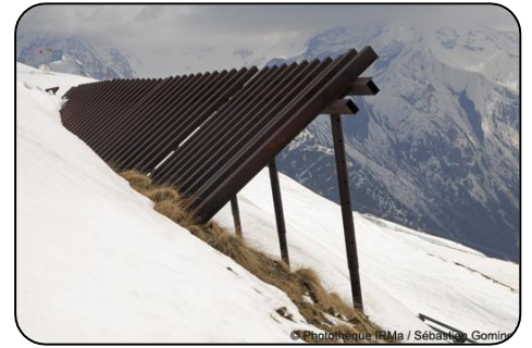
Râtelier paravalanche, combe du Replat, Isère
