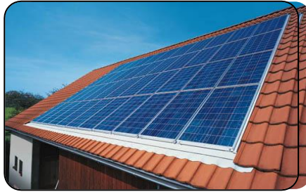
Panneaux solaires photovoltaïques
